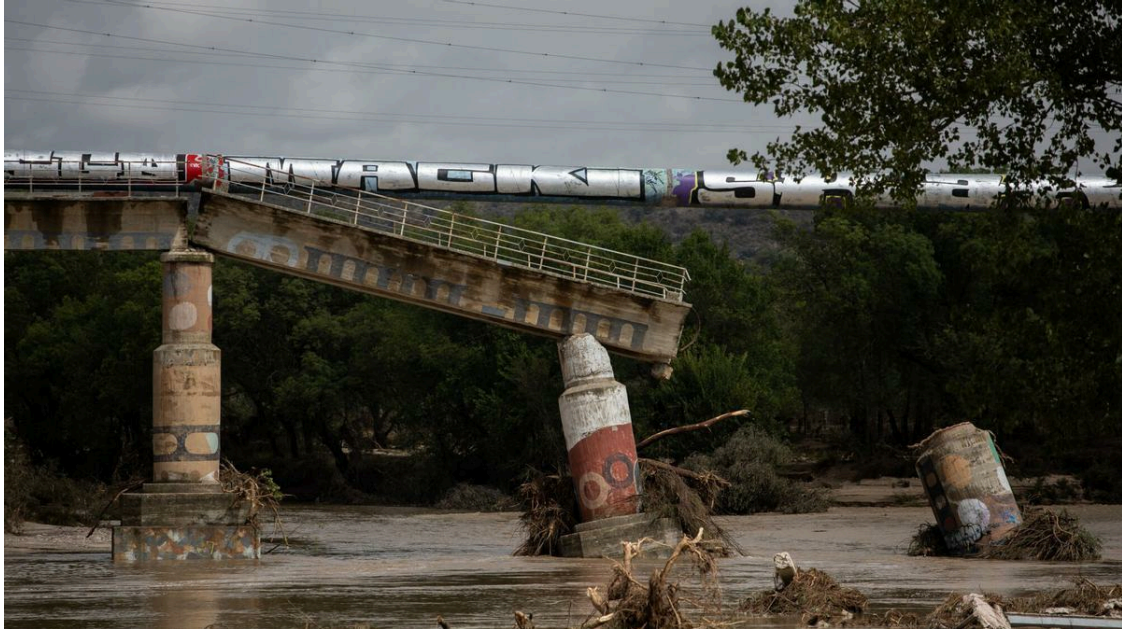
Puente colapsado debido a las inundaciones provocadas por la dana de septiembre de 2023 en Aldea del Fresno, en el suroeste de la Comunidad de Madrid.
